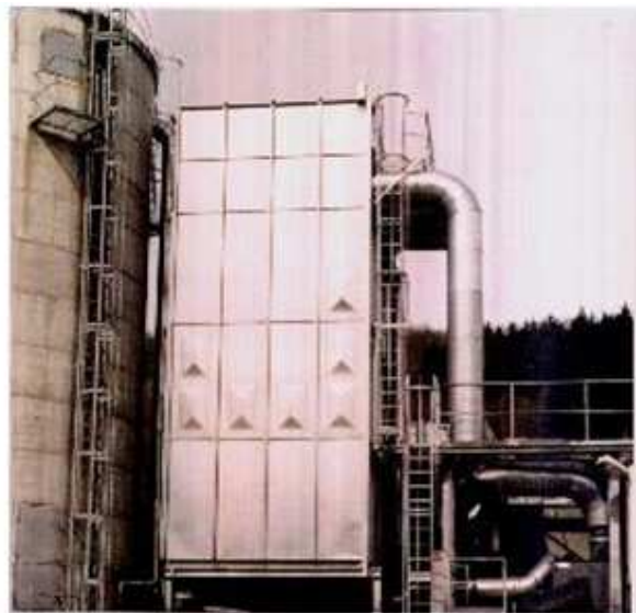
Abb. 71 - Filterhaus mit Spülluftabreinigung
