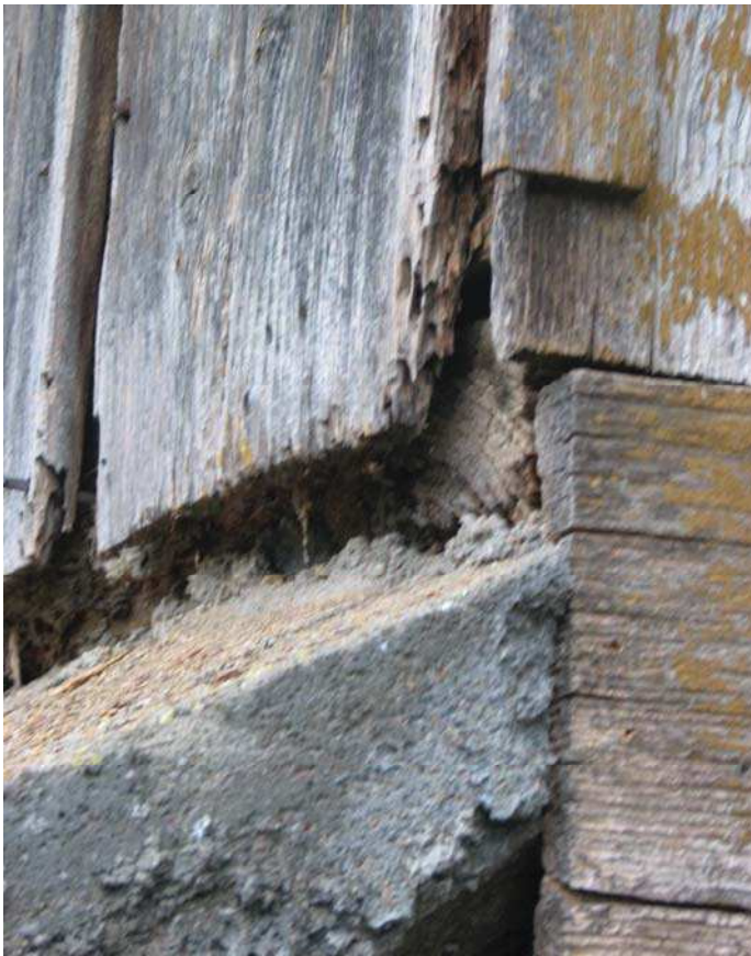
Abbildung 74: Stark zerstörte Holzschalung an der Südfassade
