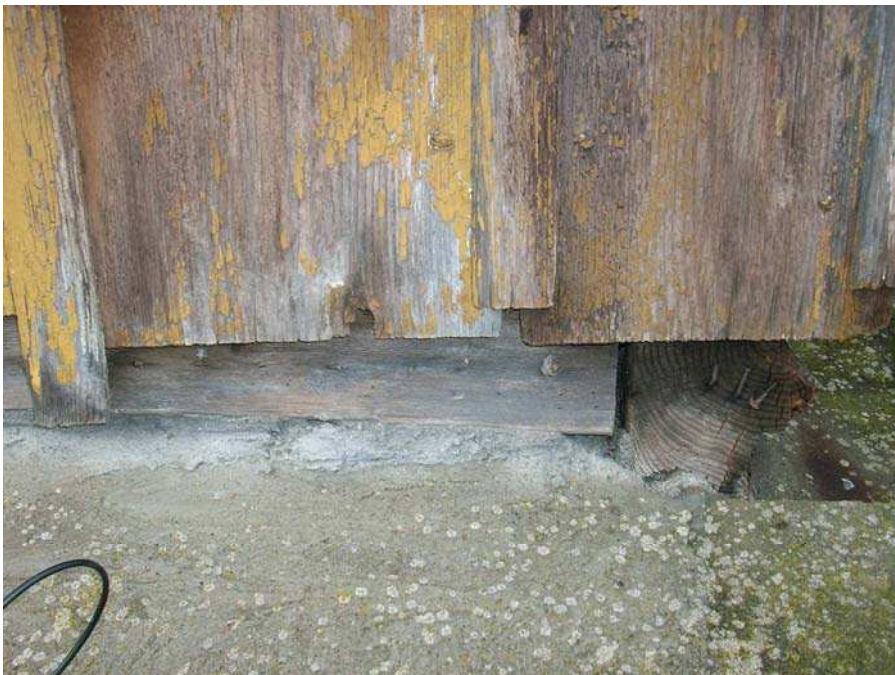
Abbildung 75: Zu kurze Schalung
