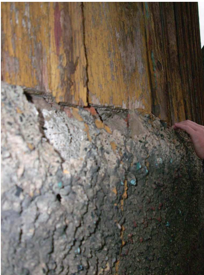
Abbildung 83: Putzkante behindert den Wasserablauf
