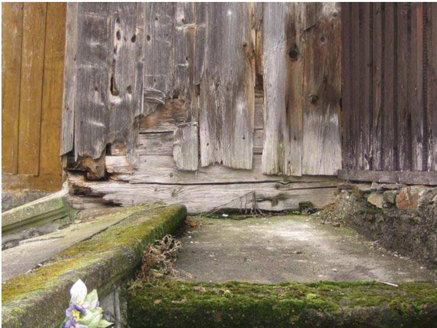
Abbildung 78: Schwellebereich mit einer Holzfeuchte > 30\% ,
