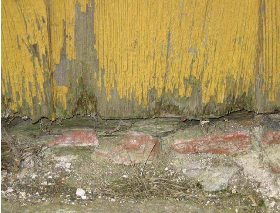
Abbildung 81: Notwendige Erneuerung der Schalung im Schwellenbereich
