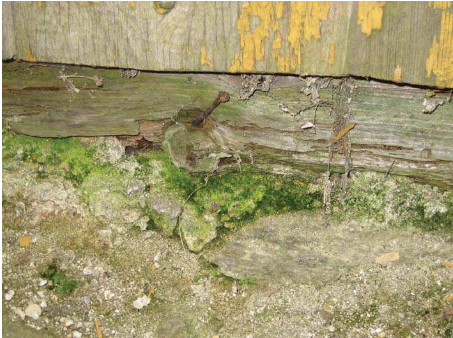
Abbildung 77: Durch Feuchtigkeit geschädigte Schwelle
