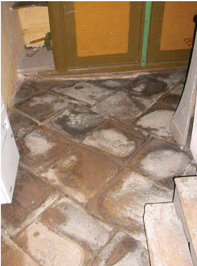
Abbildung 48: Feuchtigkeit im Bereich des Fußbodens
