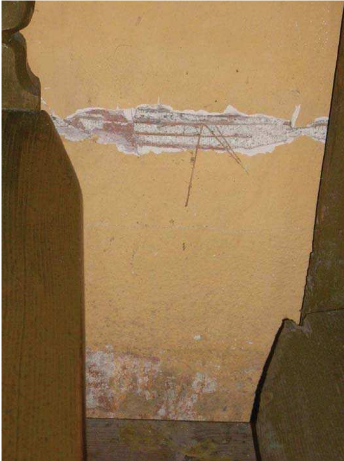
Abbildung 50: Horizontaler Riss mit Putzabplatzung
