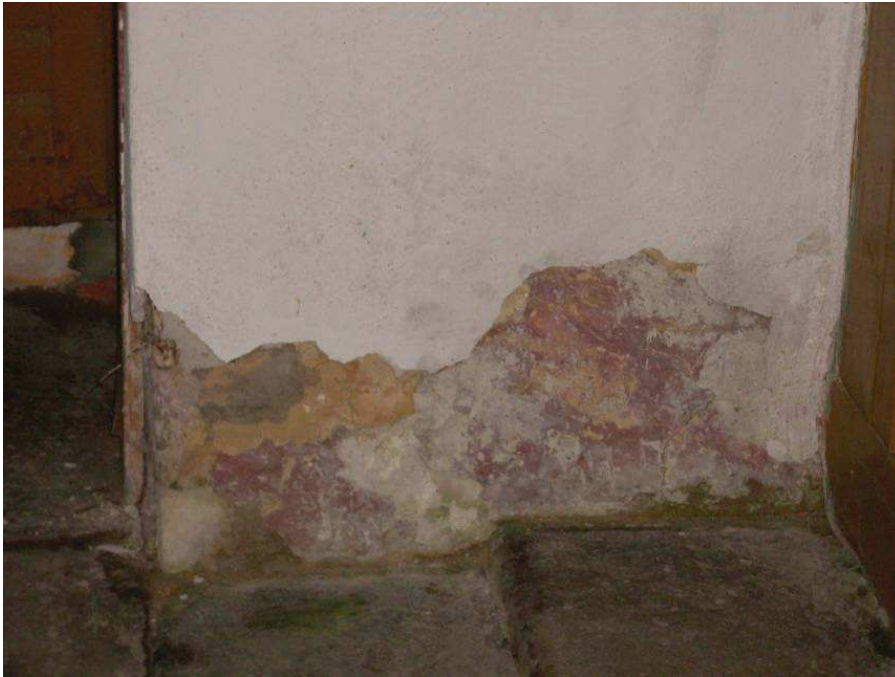
Abbildung 51: Abplatzungen im Sockelbereich
