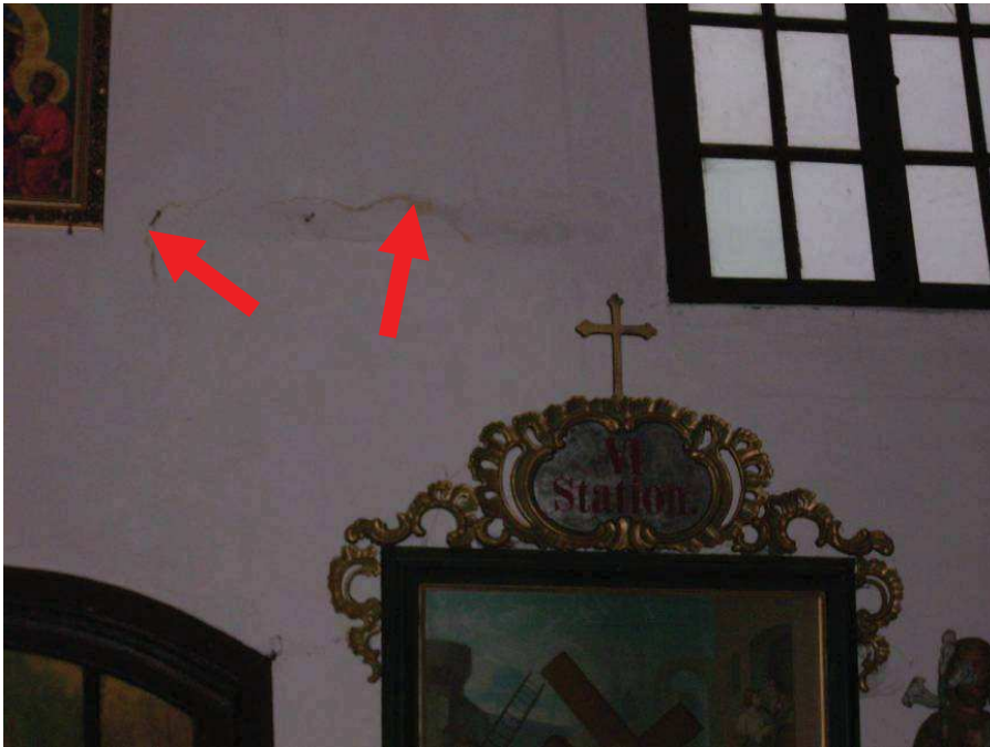
Abbildung 52: Einzelriss in der Putzoberfläche im Bereich der Fenster
