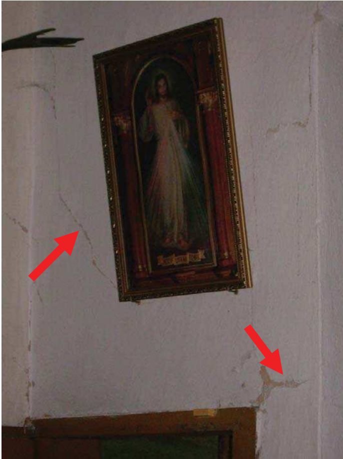
Abbildung 53: Einzelriss in der Putzoberfläche im Bereich der Tür
